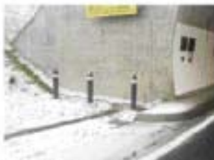
北海道開発局札幌開発建設部 国道231号厚田道路 (トンネル出口防護)
