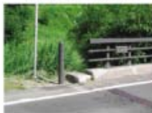
北海道開発局旭川開発建設部 国道237号奥路 (馬場周辺防護)
